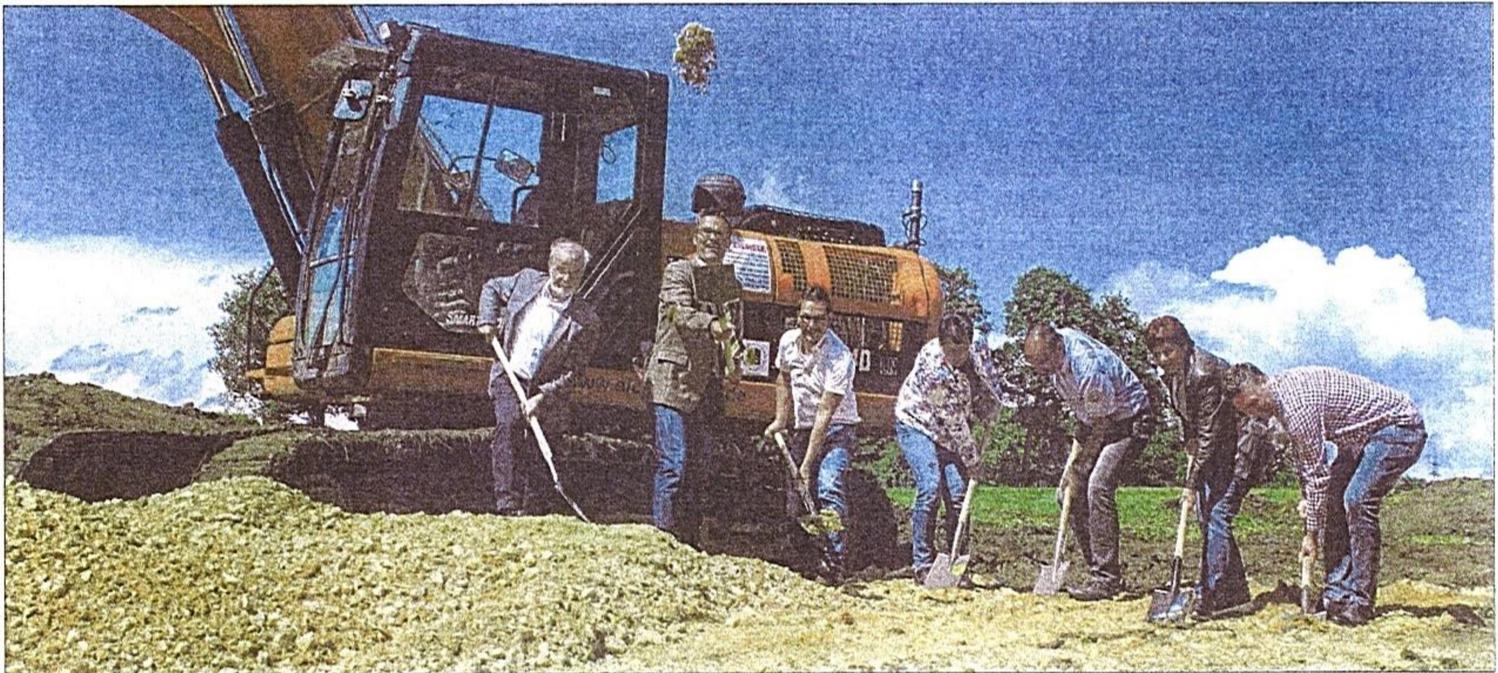
Jetzt fliegen die Erdklumpen: Bürgermeister Jürgen Stempfle (Zweiter von links) feiert den offiziellen Spatenstich zur Erschließung des Baugebiets. Gemeinderäte und Vertreter von Baufirma und Ingenieurbüro packen mit an. (Foto: dav)
